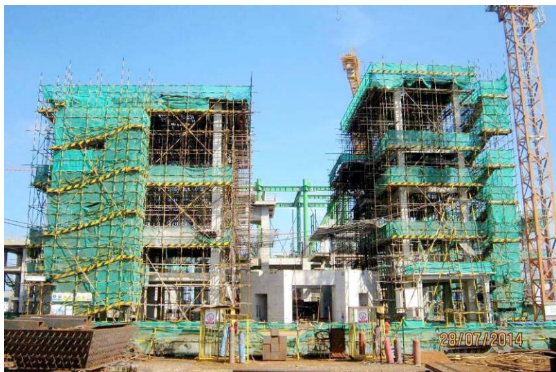
在印尼建设的泰国SCG水泥项目原料磨全景
